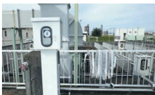
上下水道処理プラント
