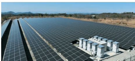
太陽光発電設備
